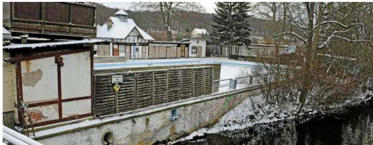
Der Blick vom Papierwehr zum Dreienbrunnenbad. Die Ufermauer stellt zugleich die Außenwand des Schwimmbeckens dar. Foto: Marco Schmidt
