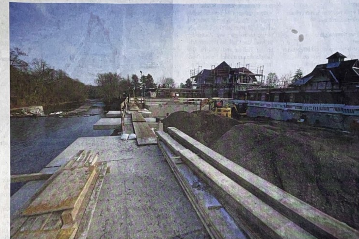
Bagger rollen am Freitag durch das künftige Becken des Dreienbrunnenbades. Von der Stützmauer ragen drei Plattformen über das Gera-Ufer.
