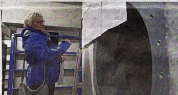
Projektleiterin Birgit Gräfenhan inspiziert den Technikkeller, der von der alten Beckengröße abgezweigt wurde.
